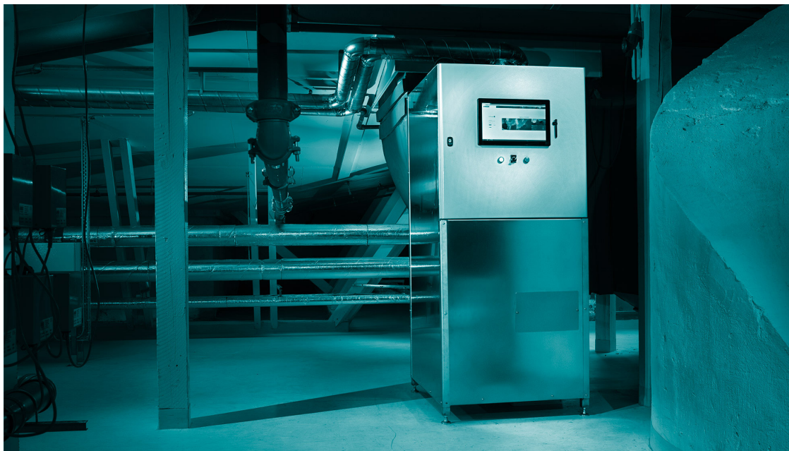
Centrala destruktionsenhet (CDU).
